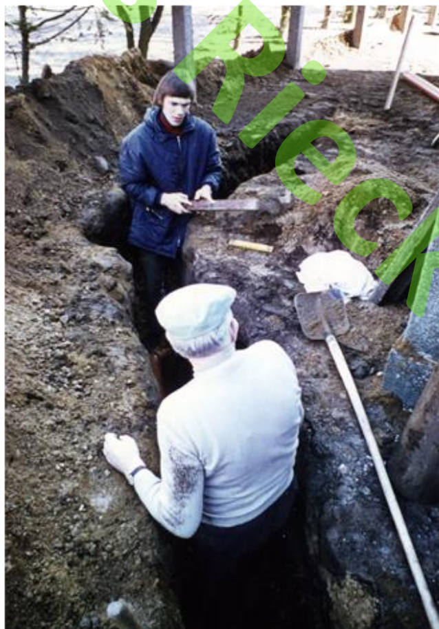
Kanalisation – bis 1973, was war das? – Nun ein Anschluss. Vorher wurden die Abwässer in einen Graben geleitet – Plumpsklo, Inhalt ging in den Misthaufen
